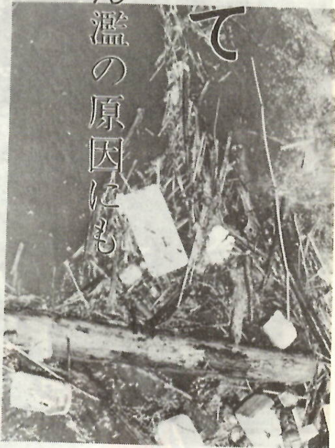
川いっばいにたまったゴミ。これが橋げたや水路を埋め洪水の原因にも……
