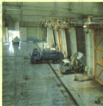
最新設備を備えたゴミビット
