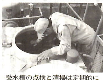
受水槽の点検と清掃は定期的に
