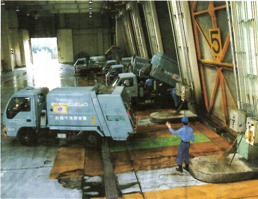
可燃ゴミを満載した収集車が次々とピットへやって来ます(六供清掃工場)
