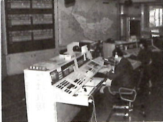
消防本部4階の通信指令室
