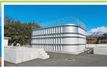
配水池（写真は富士見町石井の上柴配水場）
