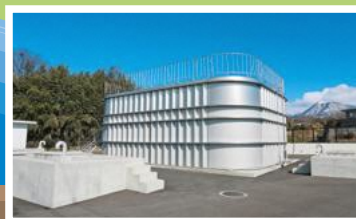
配水池（写真は富士見町石井の上柴配水場）
