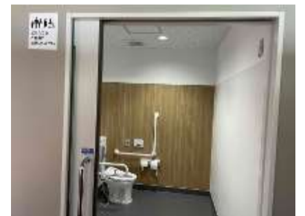
新しく設置された西校舎1階多目的トイレ
