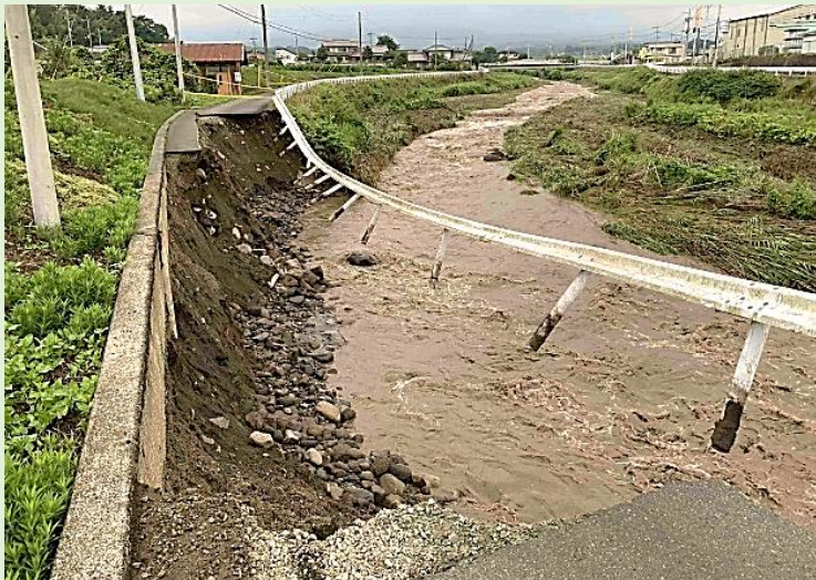
前橋市内で起こった大雨の増水による河岸崩壊の様子
