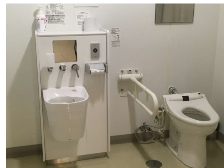
1号館1階トイレオストメイト
