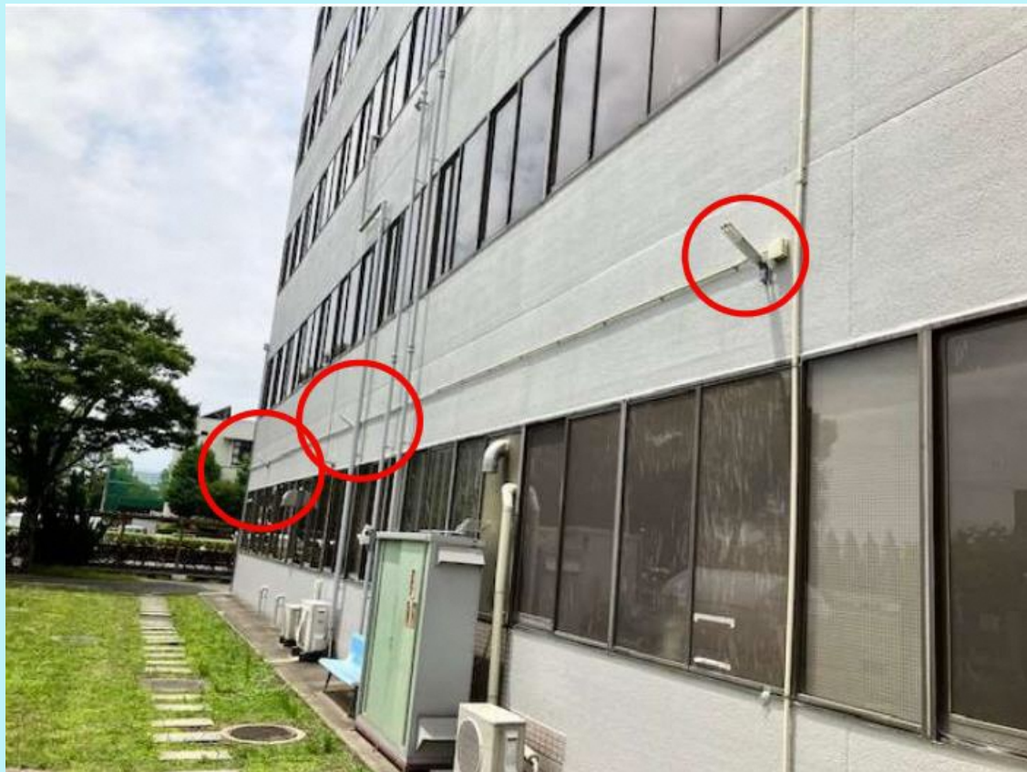
《 3号館南玄関から北側駐車場に向かう経路に防犯灯設置 》
