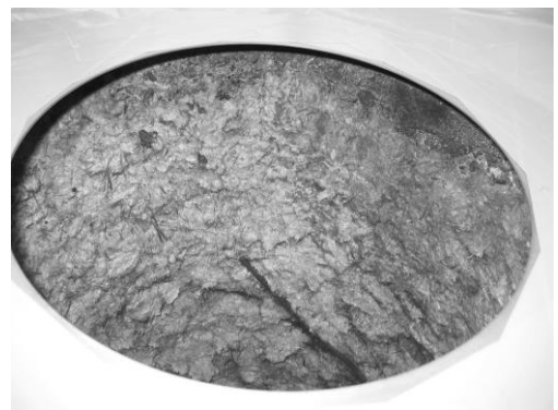
写真「煙突内の石綿断熱材」
