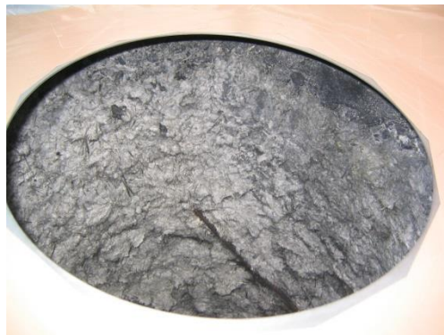
写真「煙突内の石綿断熱材」
