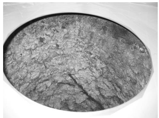
写真「煙突内の石綿断熱材」
