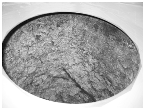
煙突内の石綿断熱材
