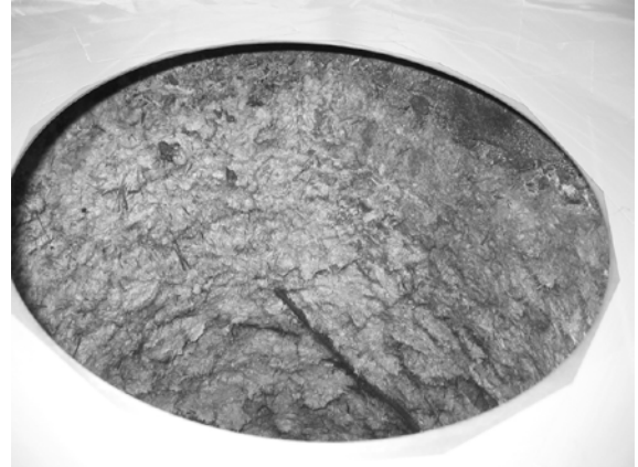
煙突内の石綿断熱材
