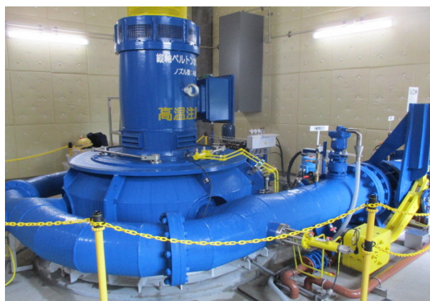
小水力発電所内にある『立軸ペルトン水車発電機』
