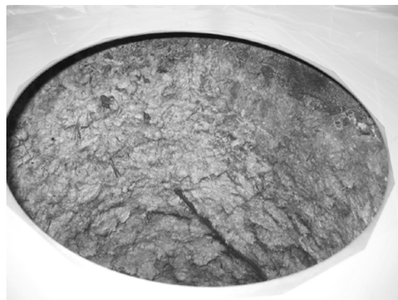
煙突内の石綿断熱材
