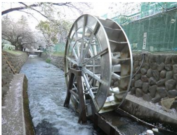
前橋こども公園内の小水力発電用水車
