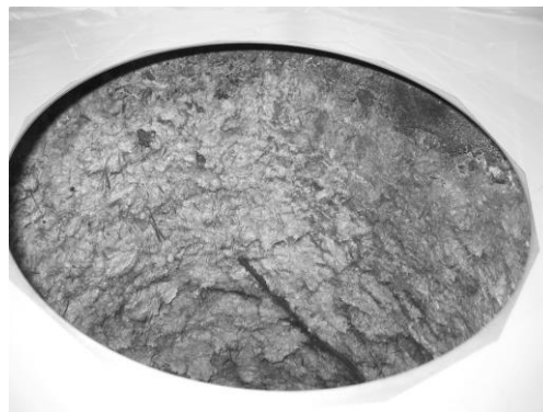
写真「煙突内の石綿断熱材」
