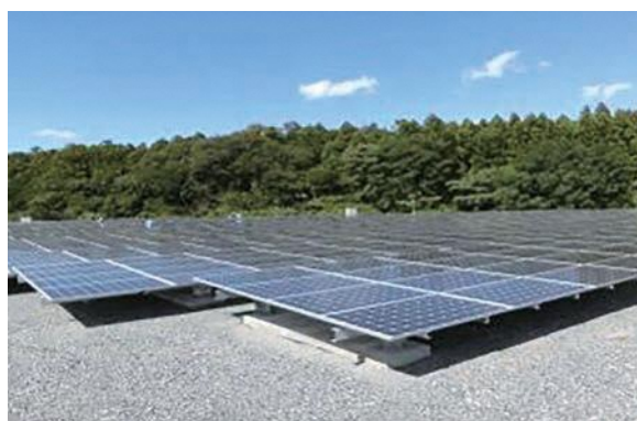
まえばし堀越町太陽光発電所
