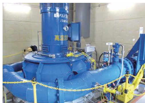
まえばし赤城山小水力発電所
