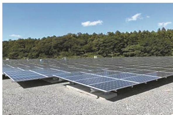
まえばし堀越町太陽光発電所
