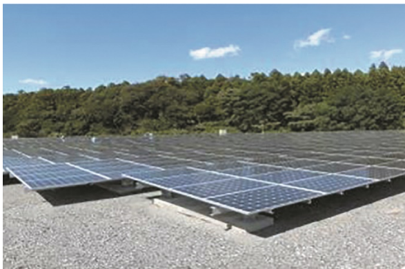
まえばし堀越町太陽光発電所
