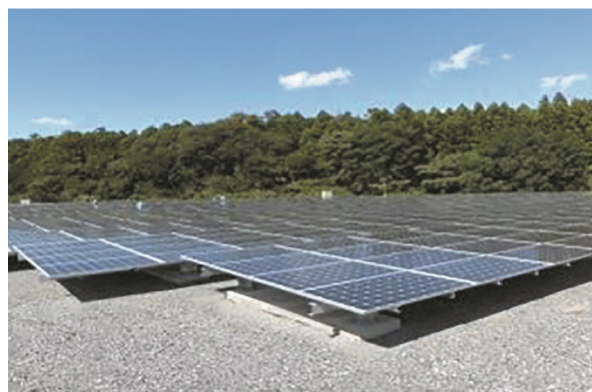
まえばし堀越町太陽光発電所
