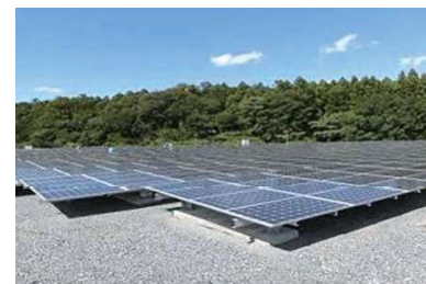
まえばし堀越町太陽光発電所
