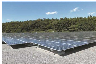
まえばし堀越町太陽光発電所
