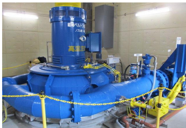
写真「小水力発電所内にある『立軸ペルトン水車発電機』」
