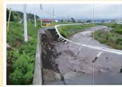
前橋市の市道崩壊
