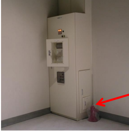
3 空調・照明操作盤（ブレーカー） 館内南側入口右側壁面にあります。
