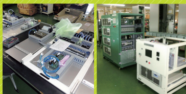
グンエイが製造した制御盤
