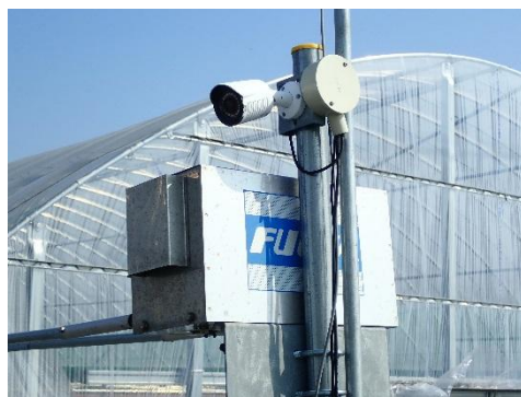
防犯カメラの設置
