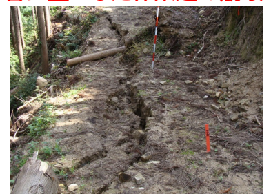
盛土で発生したクラック
