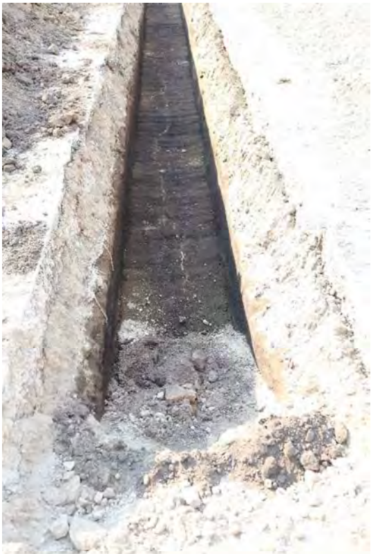
5 トレンチ地割れ
