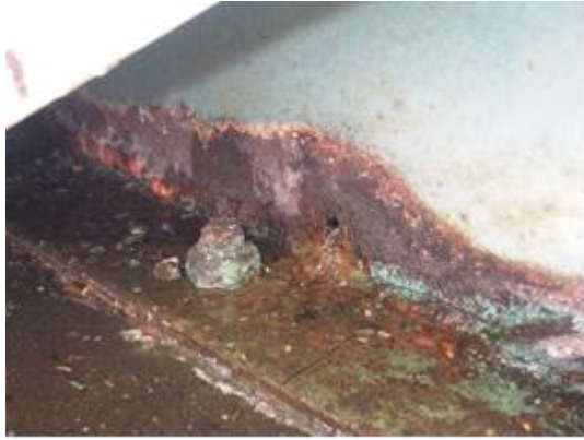
〔Ⅲ判定〕階段箱桁土台部の腐食、滞水
