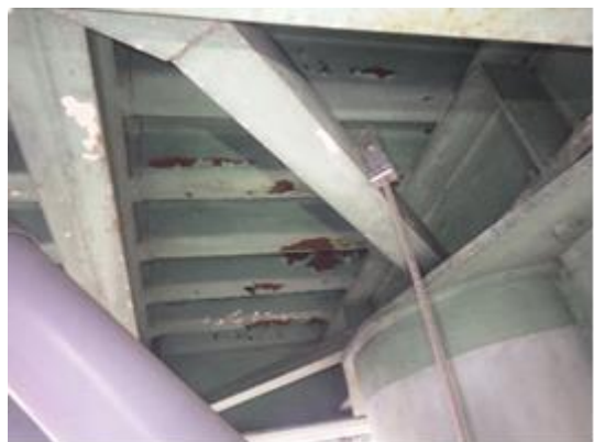
〔Ⅱ判定〕デッキプレートの腐食
