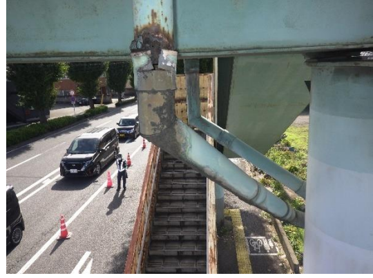
〔Ⅲ判定〕配水管の亀裂や腐食
