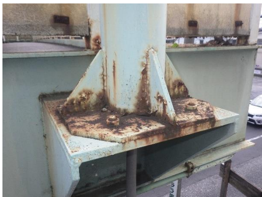
〔Ⅱ判定〕照明柱基部の腐食
