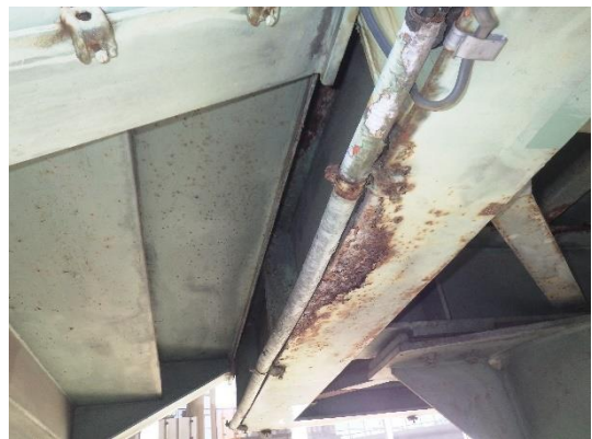
〔Ⅱ判定〕階段接合部の腐食、漏水
