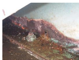
階段箱桁土台部の腐食、滯水
