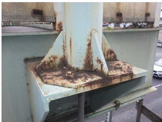
[Ⅱ判定]照明柱基部の腐食
