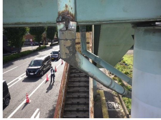
[Ⅲ判定]配水管の亀裂や腐食
