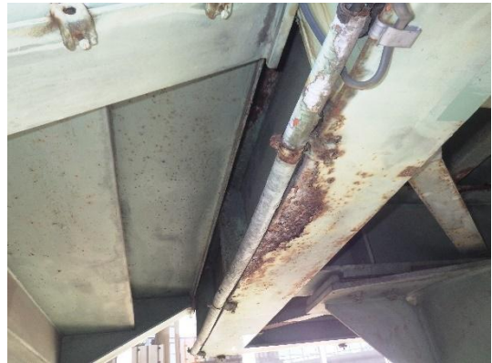
[Ⅱ判定]階段接合部の腐食、漏水
