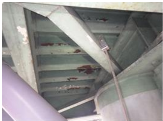
[Ⅱ判定]デッキプレートの腐食
