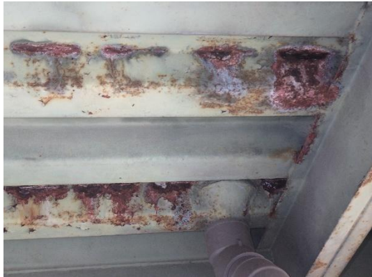
[Ⅱ判定]デッキプレートの腐食、漏水
