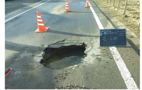
【道路陥没の状況】
