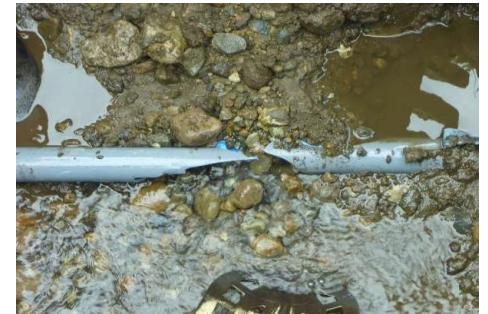
【漏水管の状況】
