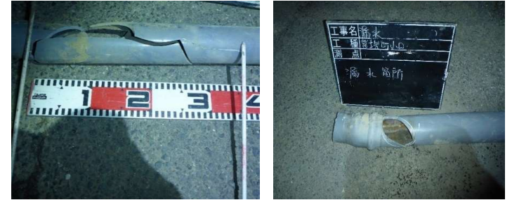
【破損した塩ビ管の写真】
