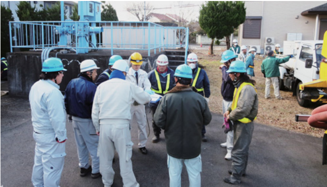
③天川ポンプ場での作業確認（汚泥の吸引運搬作業の確認をしています）
