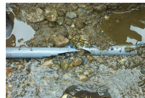
【漏水管の状況】
