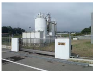
11 田島浄水場 (田島受水地点)
