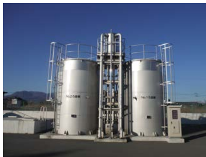
(除鉄・除マンガン急速ろ過機)
