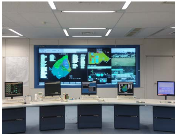
(遠方監視システム)
