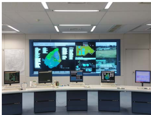
(遠方監視システム)
