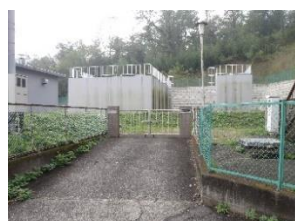
12 東金丸第1浄水場
