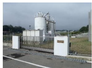
26 田島浄水場 (田島受水地点)
