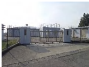
13 東金丸第2浄水場
