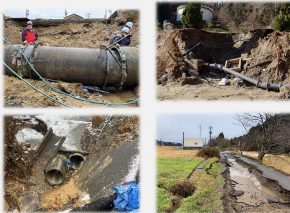
令和 6 年能登半島地震に伴う水道施設の被害状況(左:送水管、右:浄水場・導水管)
