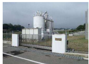
26 田島浄水場 (田島受水地点)
