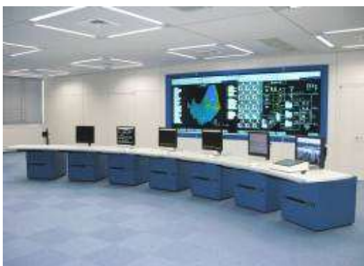
遠方監視設備
