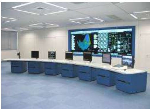
遠方監視設備
