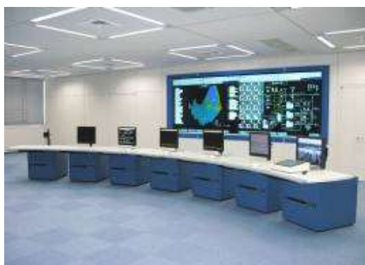
遠方監視設備
