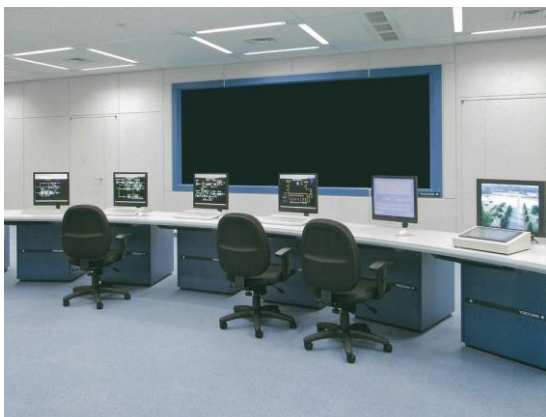
遠方監視設備
