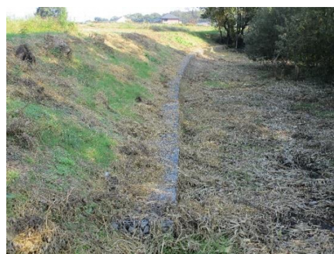
蛇笥の設置状況（二之宮地区峰下地点）
