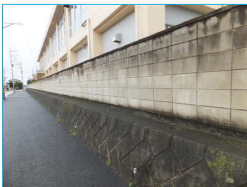
ブロック塀改修前
