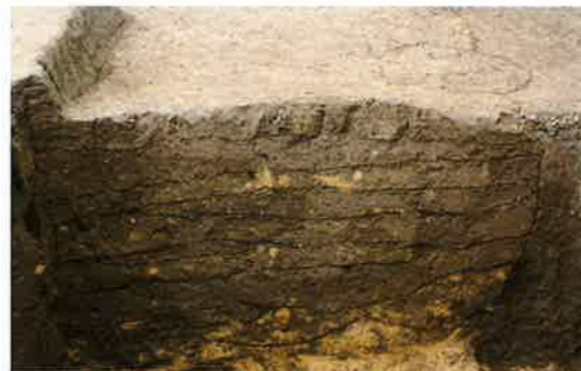
建物の基礎のようす。何回にも分けてかたくしめていることがわかります。
